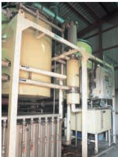
代替フロン回収装置(愛鷹工場)
