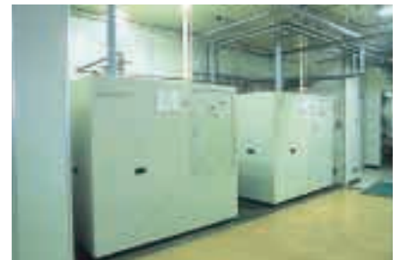
ジクロロメタン回収装置(愛鷹工場)
